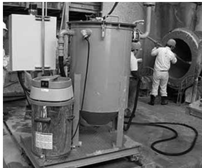
写真-2 バキューム装置
