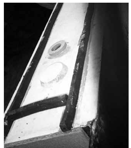
写真-2 上下接合部端面
