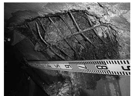
写真-2 玉石による管破壊状況
