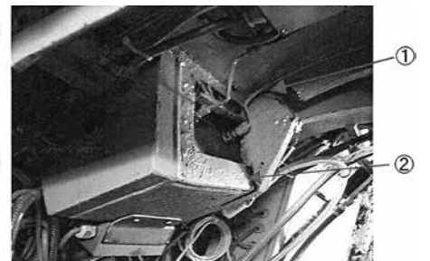
写真-5 推進機破損写真
