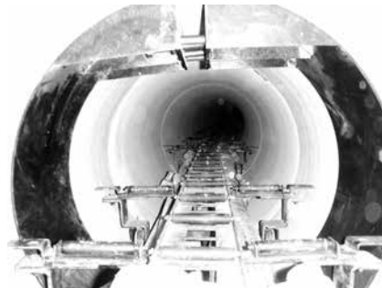
写真-3 管内ロールコンベアレール
